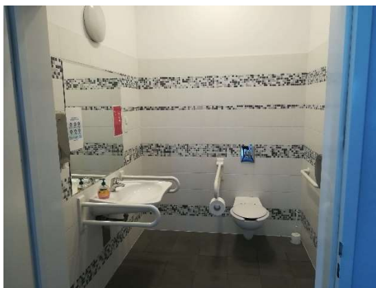
Zdj. 5. Widok toaletę na piętrze
